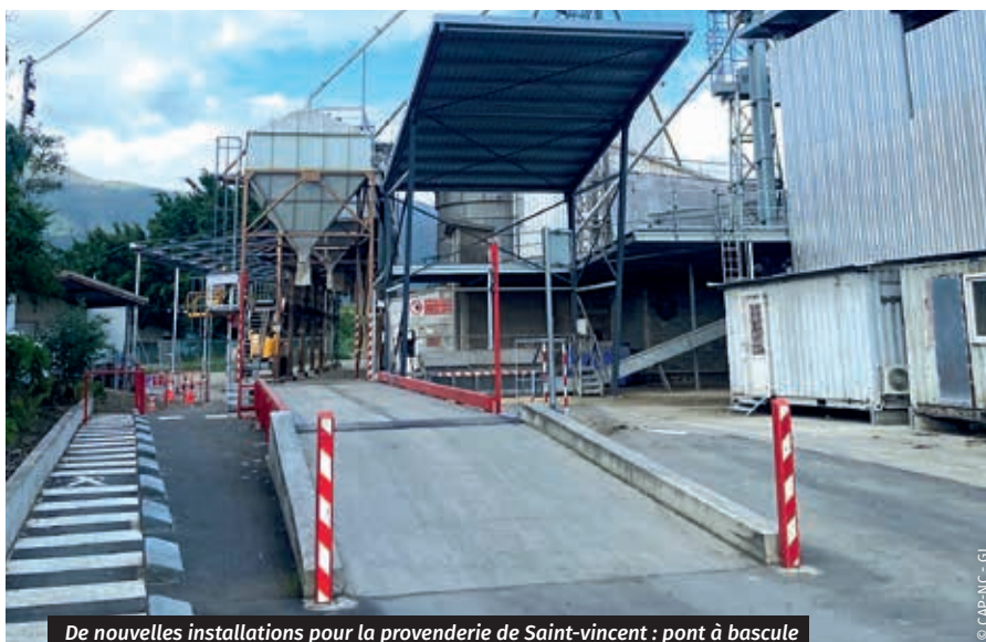
De nouvelles installations pour la provenderie de Saint-Vincent : pont à bascule et trémiés de remplissage pour faciliter l'approvisionnement par camion.
